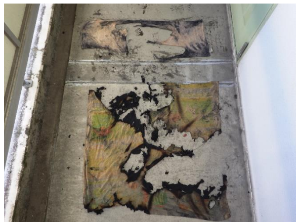
写真 6-2 焼損したタオルの状況
