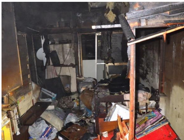
写真 14-6 居室内の焼損状況
