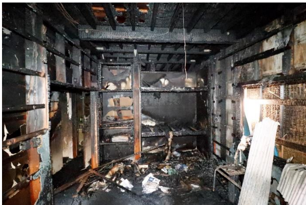
写真 6-3 居室の焼損状況
