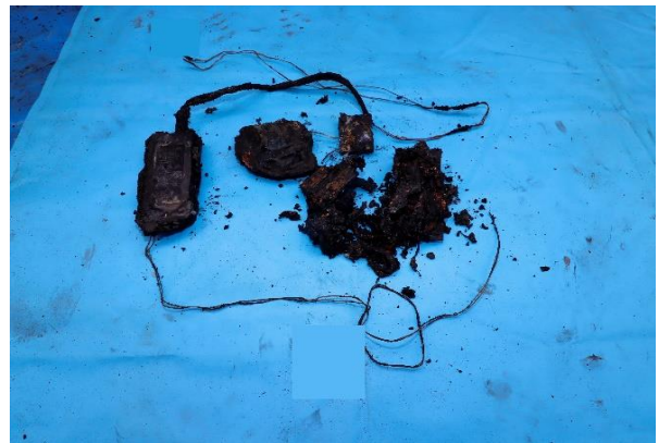
写真 6-4 バッテリーの焼損状況
