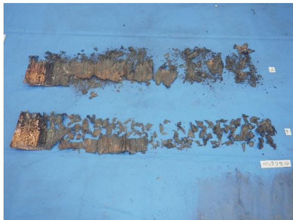
写真 6-6 焼損したバッテリーの状況
