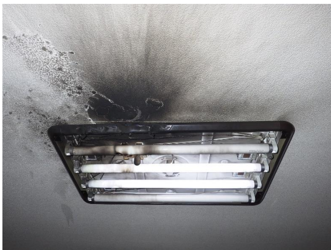
写真 11-4 焼損した照明器具の状況
