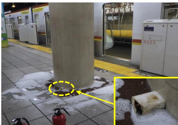
写真 6-3 ホーム上での焼損状況
