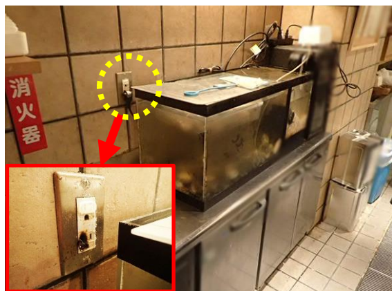
写真 6-1 壁付コンセント周辺の焼損状況
