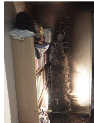
写真 13-1 焼損した居室の状況
