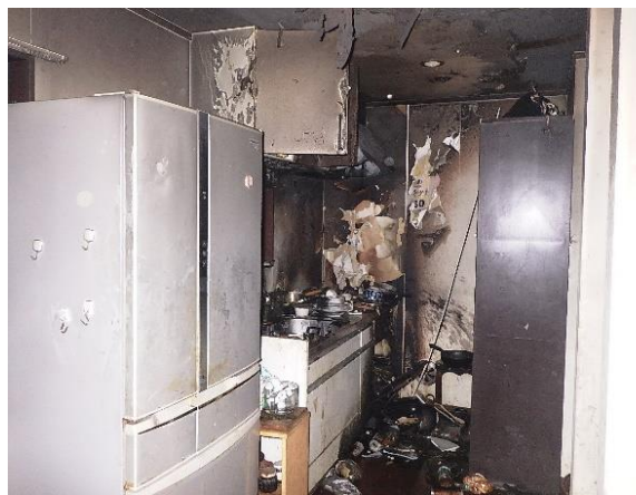
写真 9-3 出火箇所付近の状況
