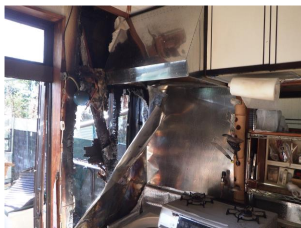
写真 7-6 壁体内の焼損状況
