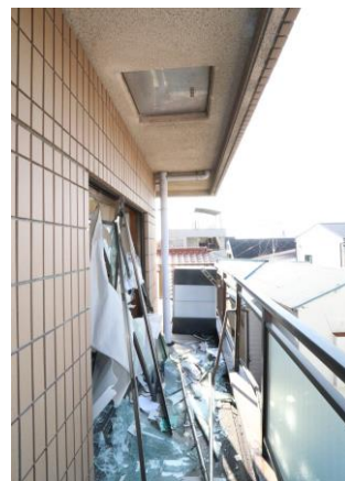
写真 11-2 爆発による損害状況
