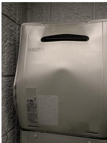
写真 12-1 焼損したガス給湯器の状況
