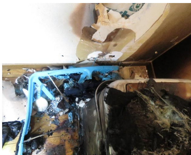
写真 8-4 石油ストーブ付近の焼損状況
