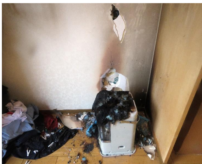
写真 8-3 焼損した石油ストーブの状況
