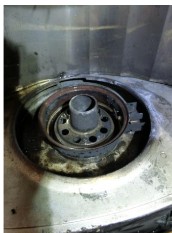
写真 8-2 芯付近の焼損状況
