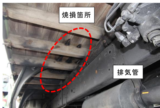
写真 30-1 荷台下部の焼損状況
