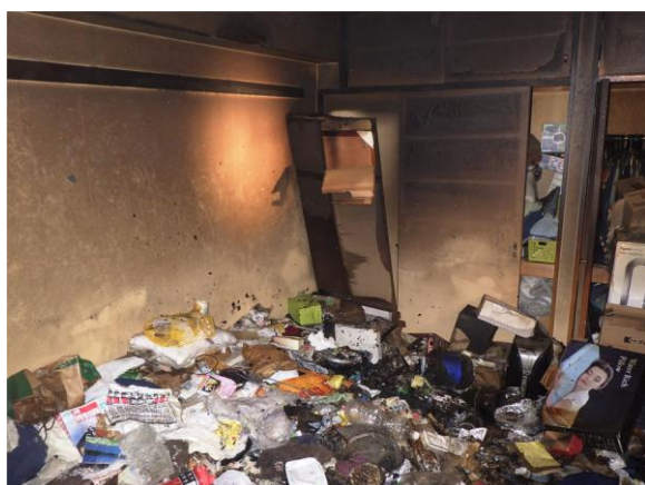
写真 18-5 出火室の焼損状況
