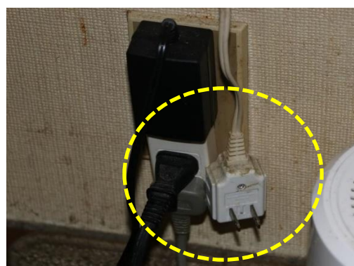
写真 18-9 住警器の差込みプラグの状況
