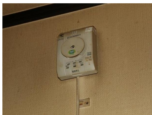
写真 18-8 複合型住警器の設置状況
