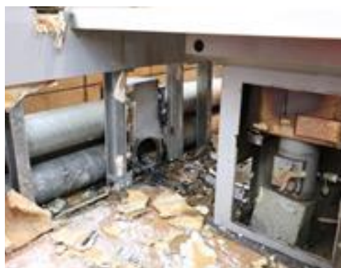
写真 19-2 ダクトの焼損状況
