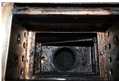
写真 19-3 防火ダンパーの作動状況
