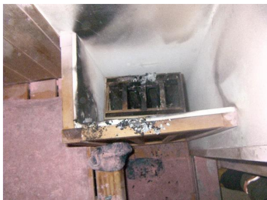
写真 22-1 焼損したサウナヒータの状況
