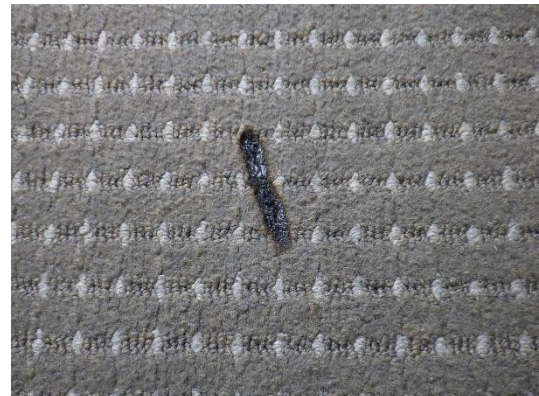
写真 22-4 カーペットの焼損状況
