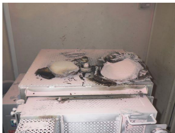
写真 22-4 陶芸用電気炉の焼損状況
