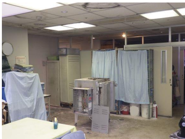
写真 22-3 作業療法室の焼損状況
