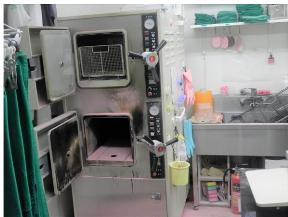
写真 23-1 滅菌器の焼損状況
