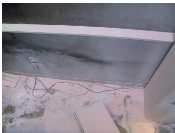
写真 23-4 ソファ裏の焼損状況
