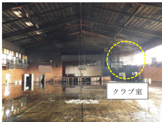
写真 23-1 体育館の焼損状況
