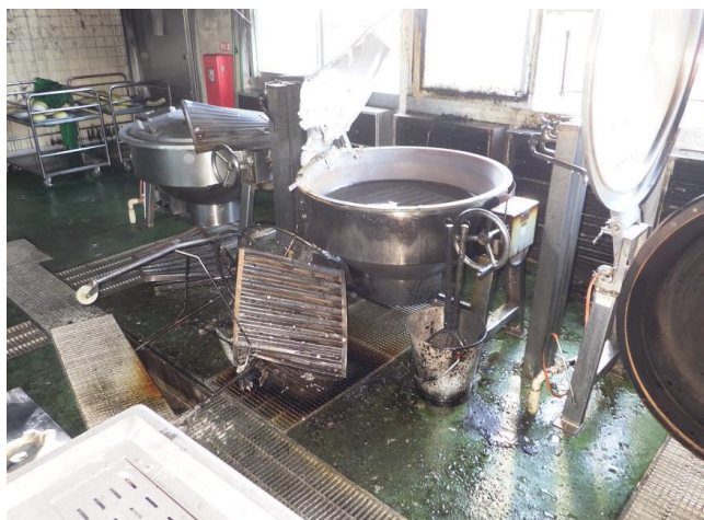
写真 23-1 調理室の焼損状況
