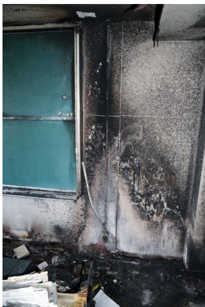
写真 24-1 焼損した内壁
