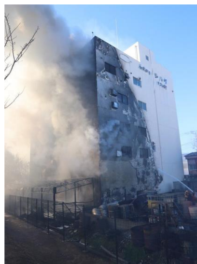
写真 24-2 敷地内の焼損状況
