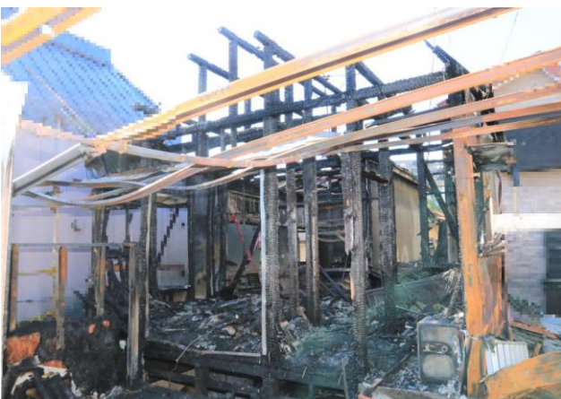
写真 25-1 焼損した倉庫の状況
