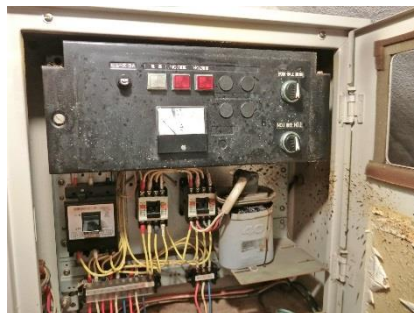
写真 26-2 操作盤の状況
