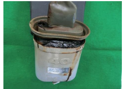
写真 26-3 進相コンデンサの焼損状況
