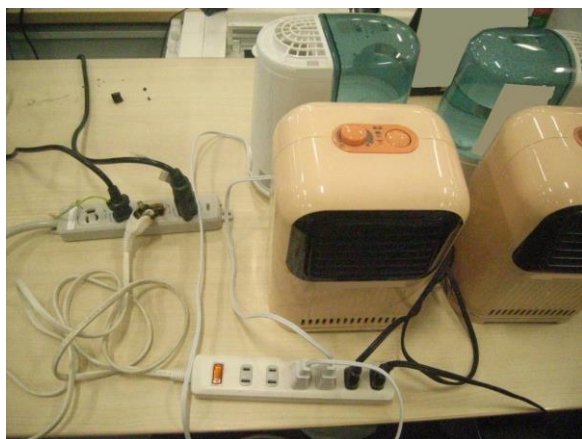
写真 26-1 電気配線の接続状況
