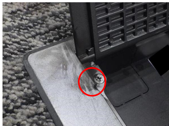
写真 26-4 フロアコンセント付近の焼損状況
