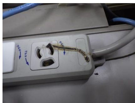
写真 26-2 テーブルタップの焼損状況
