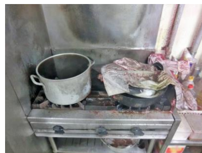
写真 28-1 大型ガスこんろの状況
