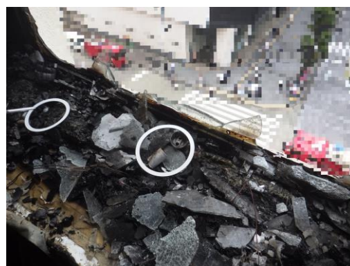
写真 32-2 蛍光灯付近の状況
