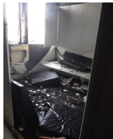
写真 32-1 焼損した客席状況
