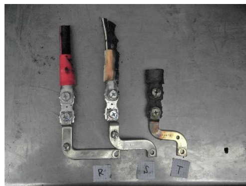
写真 32-2 結合部の状況
