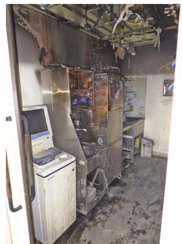
写真 32-1 処理室の状況
