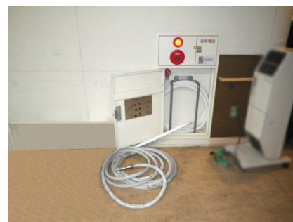
写真 32-2 補助散水栓の状況
