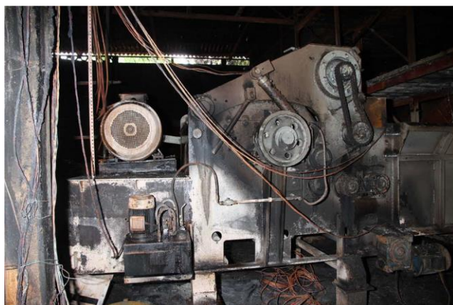
写真 28-2 破碎機の焼損状況
