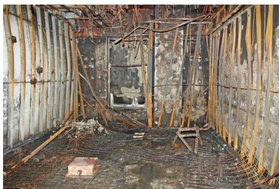
写真 16-1 出火箇所の状況
