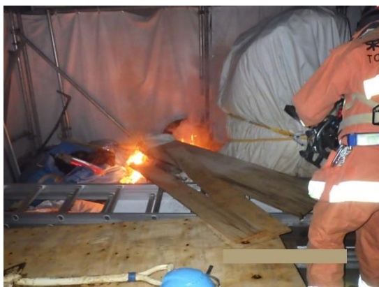
写真 10-3 工事現場内の延焼状況
