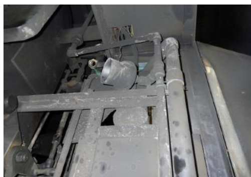
写真 30-3 二酸化炭素消火設備の状況
