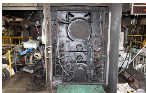
写真 30-2 出火箇所付近の状況
