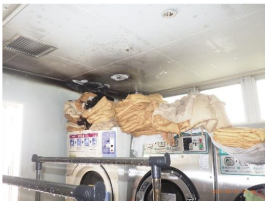
写真 30-1 出火箇所付近の状況
