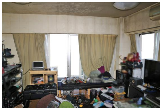
写真 31-1 出火室の状況
