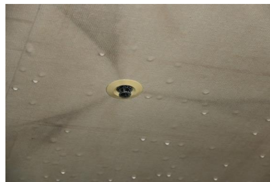
写真 31-2 スプリンクラーの作動状況
