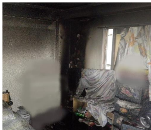
写真 31-2 出火室の状況
