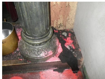
写真 31-2 防災カーテンの焼損状況
