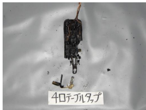
写真 14-4 テーブルタップの状況
