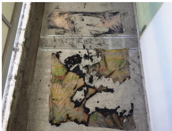
写真 6-2 焼損したタオルの状況
