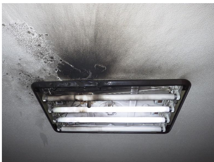
写真 11-4 焼損した照明器具の状況
