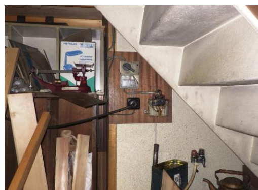
写真 24-1 コンデンサの設置状況
