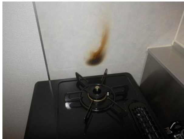
写真 7-2 内壁の焼損状況
