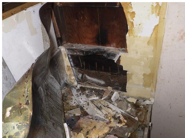
写真 7-4 壁体内の焼損状況
